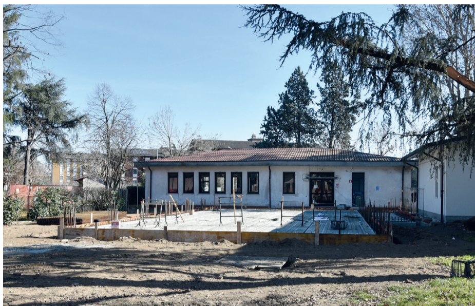
I lavori del nuovo refettorio sono ancora alle fondamenta. Alle spalle il vecchio, da demolire
