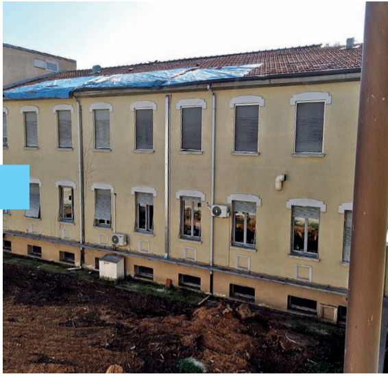
Uno dei padiglioni dell'ospedale con il tetto sfondato
